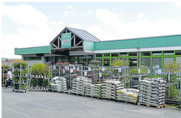
Für die Dauer der Abbrucharbeiten – veranschlagt sind sieben Wochen – wird der Raiffeisenmarkt geschlossen. In dieser Zeit wird er innen hergerichtet.
